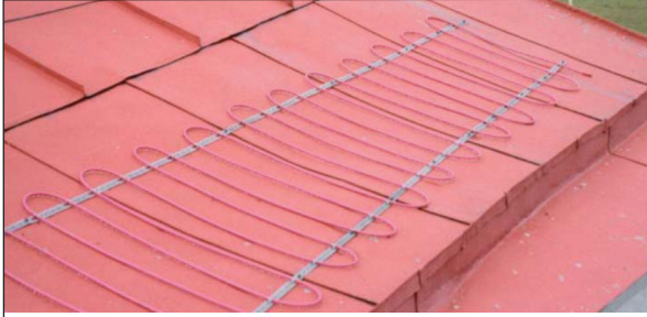
Resim 5. Oluklara, Çatı Kenarlarına Elektrikli Isıtma Uygulaması
